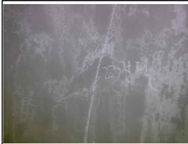
내용 우측 Sta.67m 균열(0.3mm미만)
