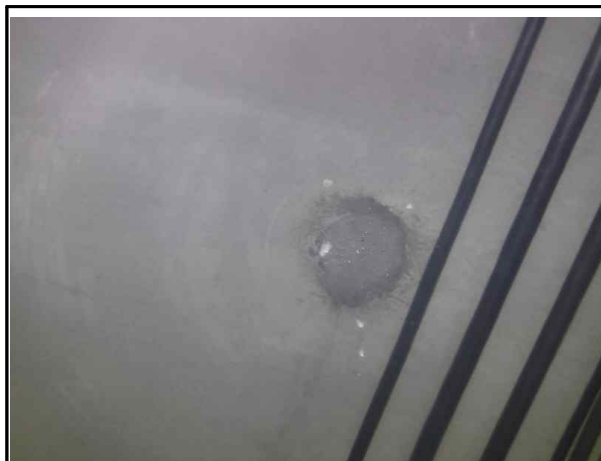
내용 천단부 Sta.106m 누수, 백태
