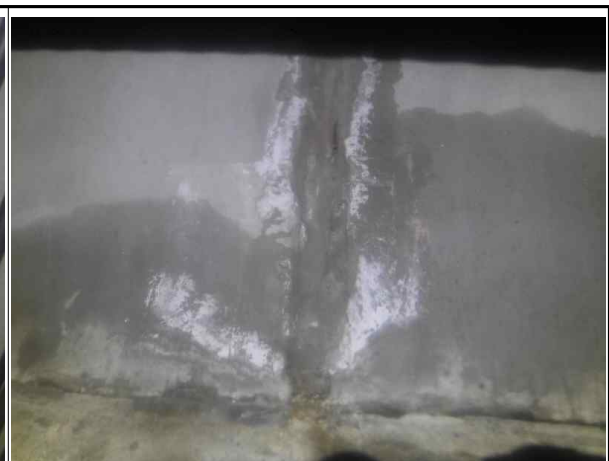
내용 우측 Sta.135m 백태
