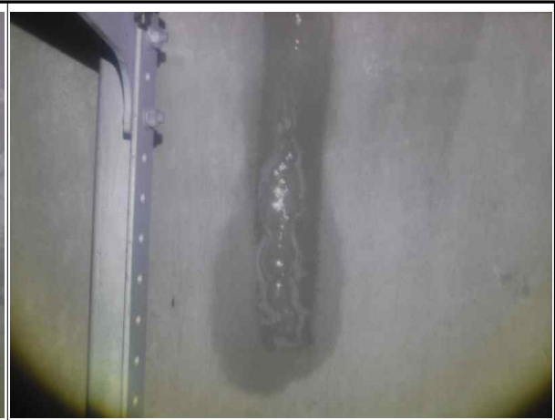
내용 좌측 Sta.97m 백태
